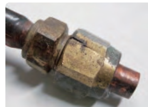
応力腐食割れによる漏えい
