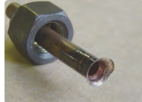
閉め過ぎによる破損
